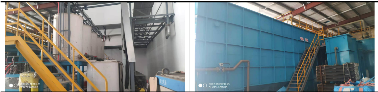
污水处理站处理设施
